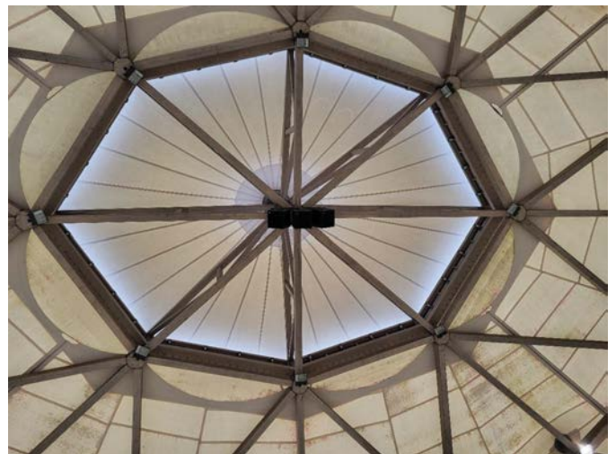
Bild 14 Aktueller Zustand der Membrane (Quelle: formTL) Current situation of the membrane
