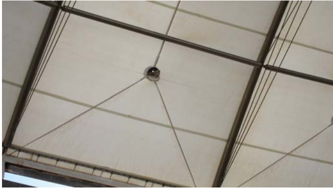
Bild 5 Beschädigte Membrane unter dem Seilknoten (Quelle: formTL) Damaged membrane under the rope node
