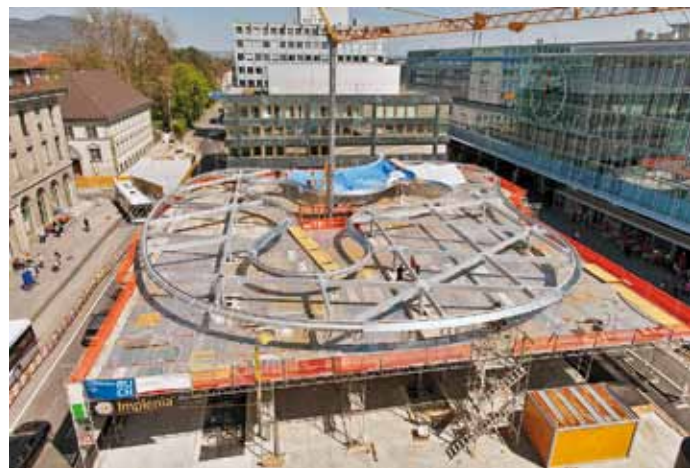
Das Tragwerk des geschraubten Stahlstisches besteht aus parallel zu den Bussteigen angeordneten Längsstreben und schräg dazu verlaufenden Querstreben, die in sternförmigen Knoten an den Stützköpfen zusammentreffen
